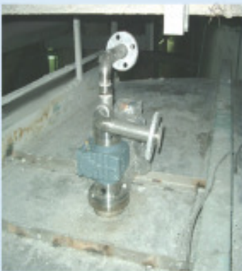
2-stufige Einheit auf dem Siebwasserbehälter
